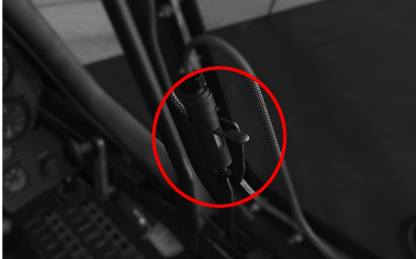
Bild: Lage des Kabinendruckventils an der Kanzelhaube rechts.
